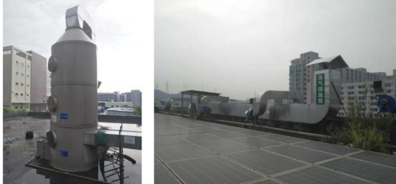
生产园区废气处理系统
