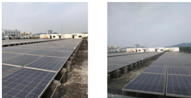
园区太阳能发电板
